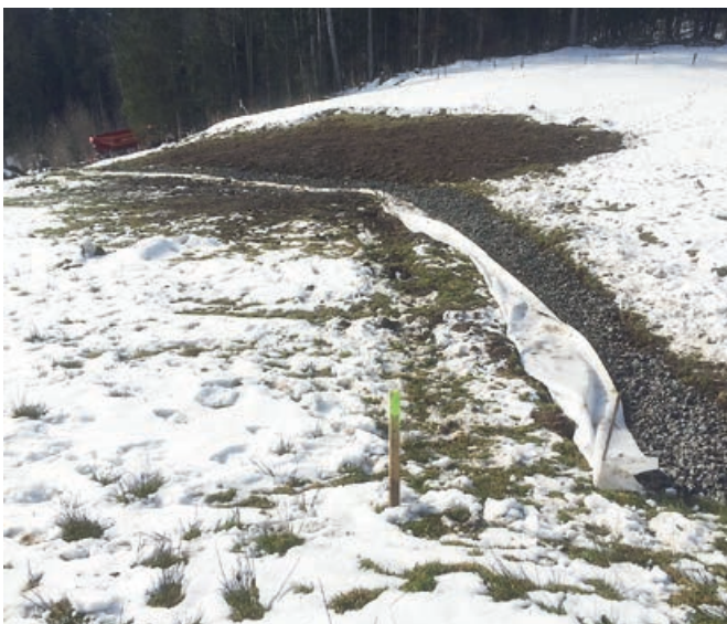
Mit Sickerleitungen wird versucht oberhalb der Strasse möglichst viel Wasser zu fassen und abzuleiten.
