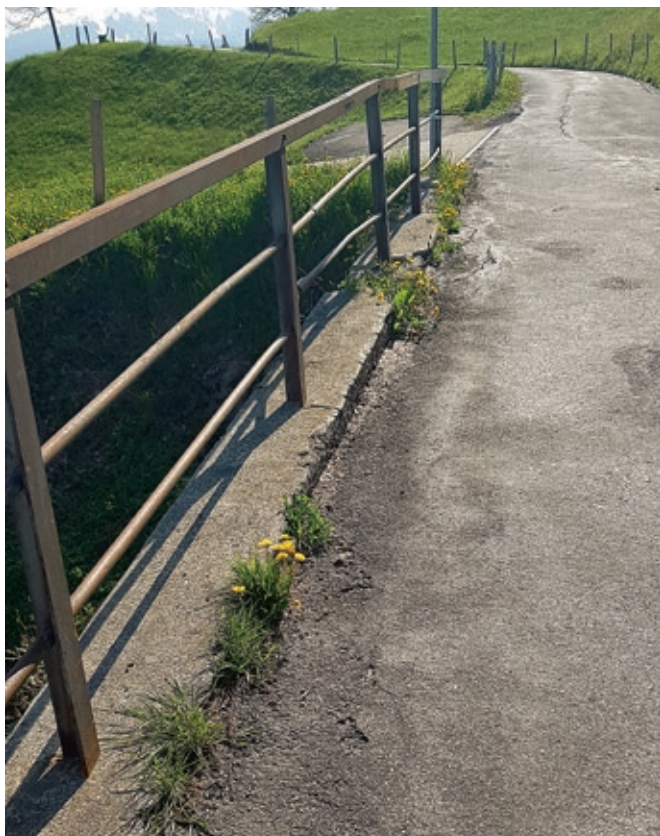
In den vergangenen Jahren sind an der Bergstrasse verschiedene Schäden zu Tage getreten, die behoben werden mussten.
